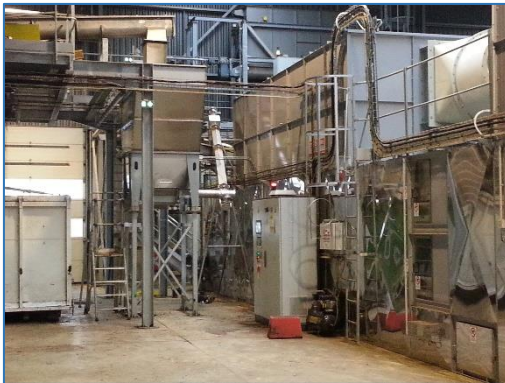
SECHEUR DIGESTAS PHASE SOLIDE
