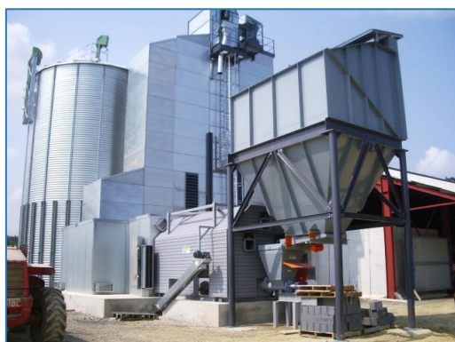
SECHEUR CEREALES + ENERGIE BIOMASSE
