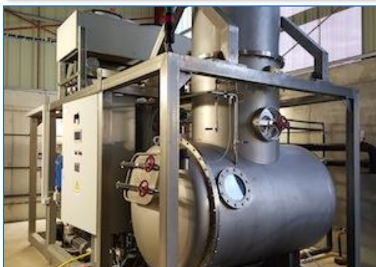
SECHEUR DIGESTAS PHASE LIQUIDE
