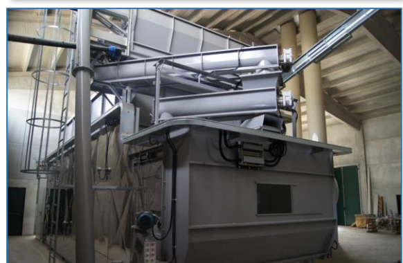
SECHEUR DIGESTAS PHASE LIQUIDE
